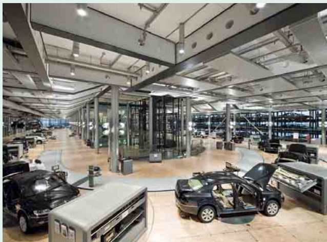
① Effiziente Beleuchtung mit Lichtwerfern und Spiegeln Nur in den schwierigen Eckbereichen gibt es andere Leuchten.
