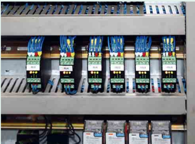
② Entmagnetisierer-Module im Schaltschrank sorgen für störungsfreie Prozesse
