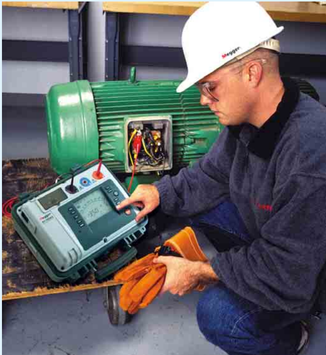
⑤ Neuere Prüfgeräte analysieren mit verschiedenen Prüfmethode den aktuellen Zustand der Isolation
