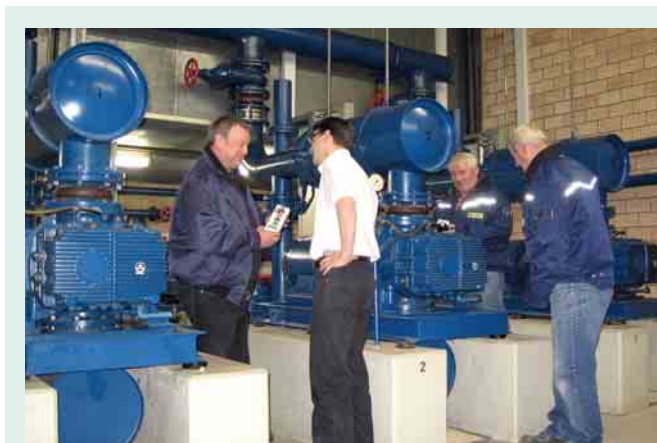
① Inspizieren die generalerneuerte Kläranlage in allen Details: Betriebsleiter Wolfgang Drobik (l.) und Heldele-Abteilungsleiter Sascha Schurer (im weißen Hemd) Foto:
