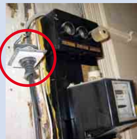
2 Kein Baustromanschluss im Sinne der BGI 608
