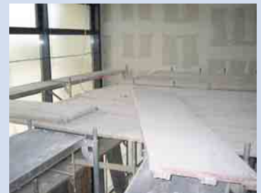
3 Gerüst-Plattform mit Absturzgefahren
