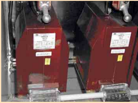
❶ Vermeintlich freigeschaltete Wandlerzelle mit Kugelfestpunkten
