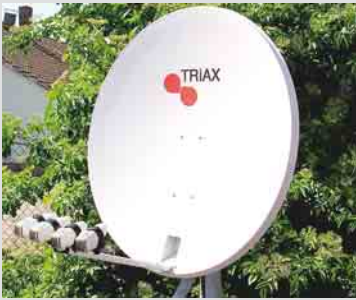
⑥ Satellitenantenne für den Empfang von vier geostationären Satelliten
