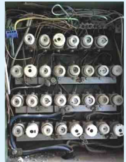
① In Betrieb befindlicher Verteiler – verdeckt, Änderungen nicht fachgerecht, keine Fingersicherheit, unverschlossen usw. usw.
