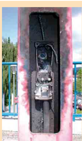
① Im Anschlussraum der Uhrensäule löste der Monteur einen Lichtbogen aus
