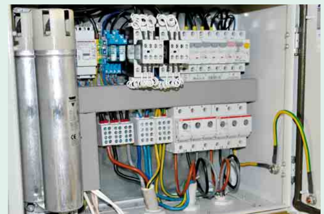
3 Blindstromkompensationseinheit für zwei BHKW im Werner Heisenberg Gymnasium Riesa
