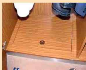
1 Bodenklappe im Kleiderschrank als Zugang zur E-Installation
