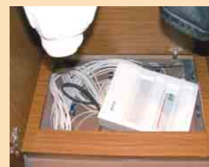
2 Nichtbefestigter Verteiler auf feuergefährlicher Unterlage
