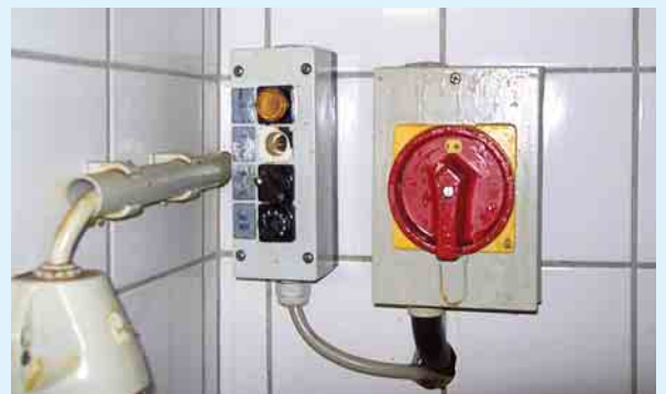
④ Lüftertaster ohne Leuchttasterabdeckung und mit Gehäuseriss im Heißfett-Backbereich; alle Installationsgeräte haben einen gelblichen Ölschleier, der Taster war zu mehr als 50 % mit Öl gefüllt
