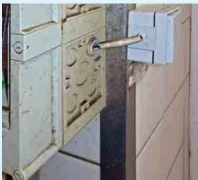
② „Geprüfte Installation“ im Mehl-lager und in der Mehlbeschickung (Ex-Bereich) mit fehlender Mantelisolierung an den Gehäuseeinführungen
