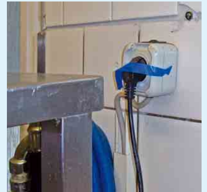
❶ Feuchtraum-Steckdose ohne Klappe im Abwaschraum einer Backwarenfabrik – ein jahrelanger Zustand, obwohl „die Elektriker“ fast jede Woche einmal vor Ort sind
