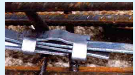
8 Keilverbinder – ungeeignet bei Rüttelbeton!
