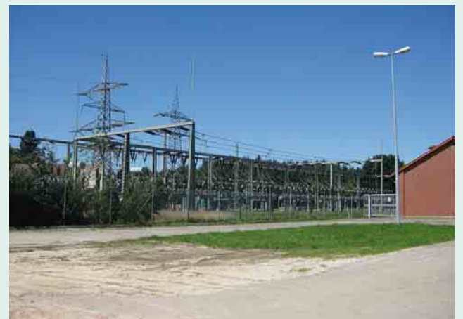
3 Im Umspannwerk Düşhorn in der Nähe von Fallingbommel wurde die 20-kV-MS-Schaltanlage modernisiert – einschließlich Sekundärtechnik und Schaltwarte
