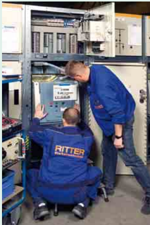
④ Schaltanlagenfertigung bei Ritter in Olfen – diese Anlage wird in das Umspannwerk Düshorn geliefert
