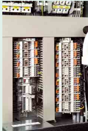
⑤ In der Niederspannungs-nische wird die gesamte Sekundärverdrahtung mit Zugfederklemmen ausgeführt
