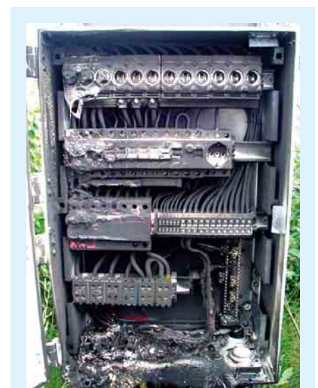
3 Ausgebrannte Verteilung aufgrund loser Klemmstellen
