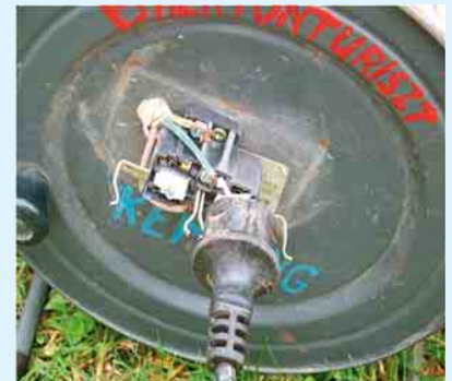
2 Geflickter Anschluss an einer Kabeltrommel
