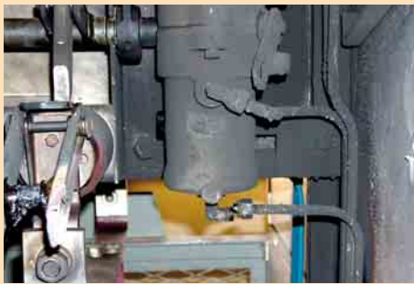
❶ Trenner mit gelöster Druckluftleitung
