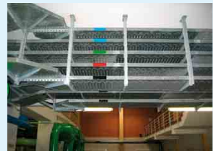
② Vorbildliches Verlegesystem mit getrennter Verlegung der Kabel und Leitungen für die Energieversorgung und für die informationstechnischen Systeme, links im Bild die Verbindung der parallel geführten Systeme
