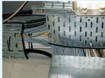
① Unzureichende Verbindung an den Stoßstellen von Leitungsführungssystemen
