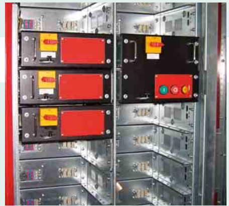
1 Schaltfeld in der Bauweise Schubeinsatz-Technik/MCC Fa. Minis+Systeme
