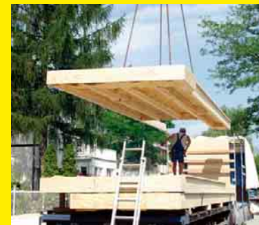
1 Viele Unfallgefahren auf Baustellen Foto: Wistuba
