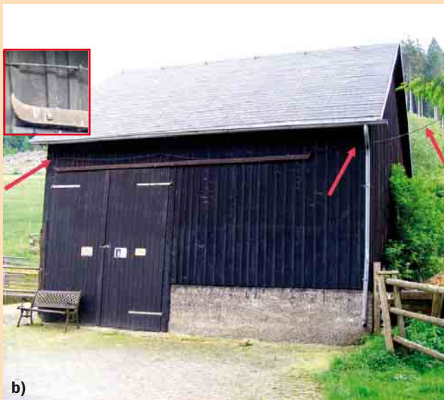
③ Beispiele unzulässiger Leitungsführung im Detail
