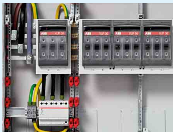
6 Teilansicht eines Hauptverters mit Aufrasten des Blitzstromableiters auf eine Hutschiene unterhalb der Sammelschienen gemäß Abschnitt 4.6 a) und mit geschlossenen NH-Sicherungs-Lasttrennschaltern (SLTS)
