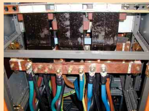
1 Unterer Schaltraum, wo der Monteur an Spannung kam
