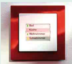
7 Funksender erkennen an der Stellung des Schließhebels, ob ein Fenster geschlossen (grün), geöffnet (rot) oder gekippt (gelb) ist und melden dies an den neben der Haustür angebrachten Schalter mit LED
