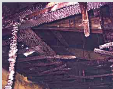
1 Erkaltete und abgelöschte Brandstellen weisen ein erhebliches Gefahrstoffpotential auf
