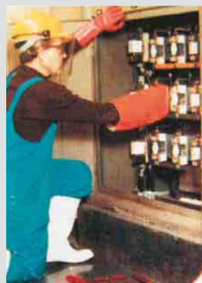
② Persönliche Schutzausrüstungen (PSA) beim Wechseln von NH-Sicherungen
