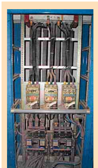
1 Schaltfeld mit Leistungsschaltern
