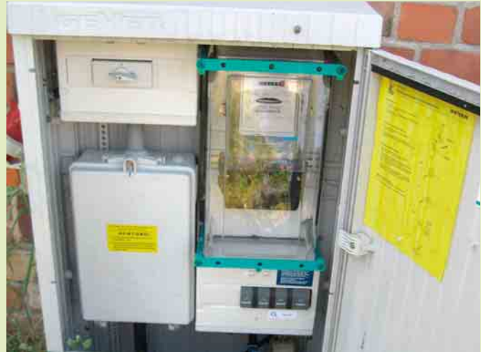
❷ Schutzisolierte Einbauten in der ZAS Metallene Befestigungsschrauben durchdringen das Gehäuse oben links
