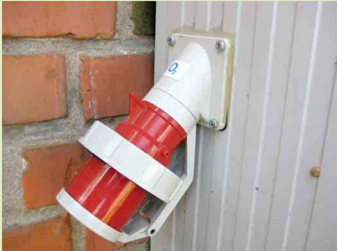
❶ Außenansicht der mit Metallschrauben an der ZAS befestigten Kragensteckdose
