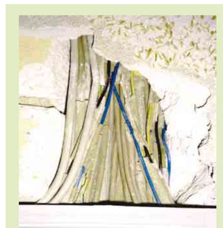
1 Brüchige Umhüllungen von Stegleitungen
