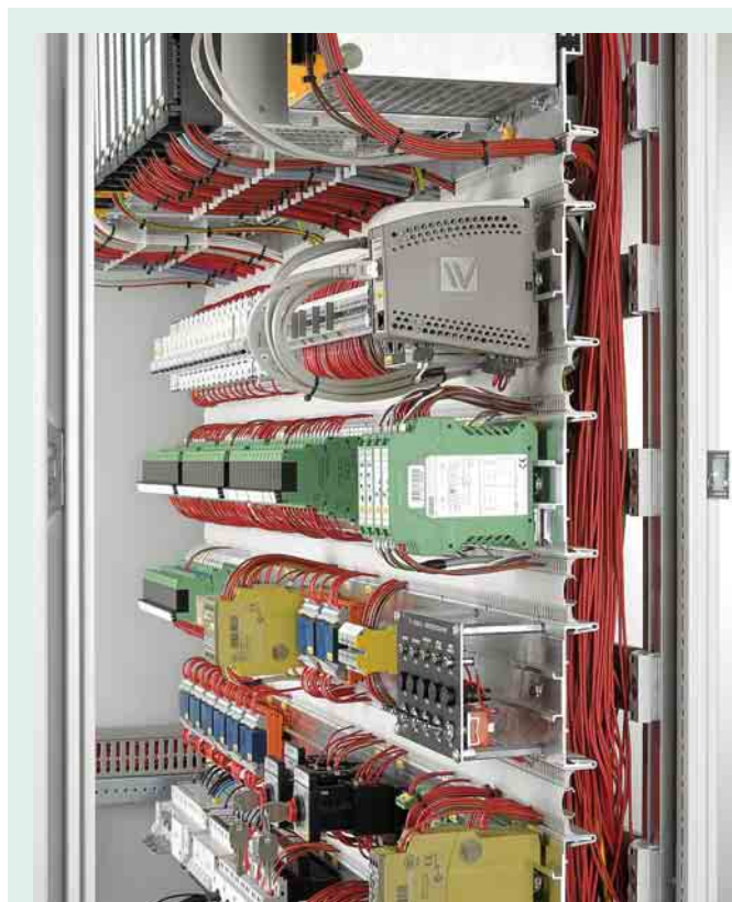
1 Schaltschrankaufbau eines LSC-Verdrahtungssystems mit modularem Aluminiumrahmen und rückseitiger Verdrahtung
