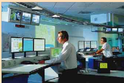
◀ ② Blick in eine Sicherheitszentrale der chemischen Industrie
