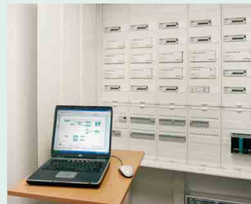
2 Blick in den Technik-Raum
