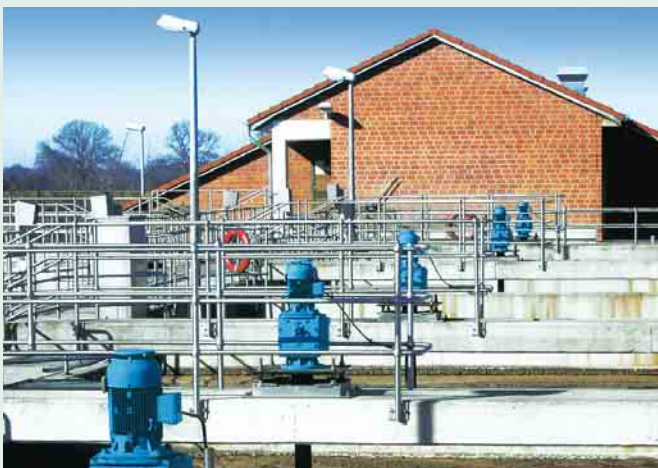
4 Beispiel einer Pumpenstation in einem Klärwerk
