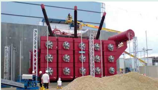
3 Zu den Vorbereitungen für den Betrieb als komplettes GuD-Kraftwerk gehört auch der Einbau des Hochspannungs-Transformators. Er hat eine Leistung von 705 MVA bei Spannungen von 420/21 kV
