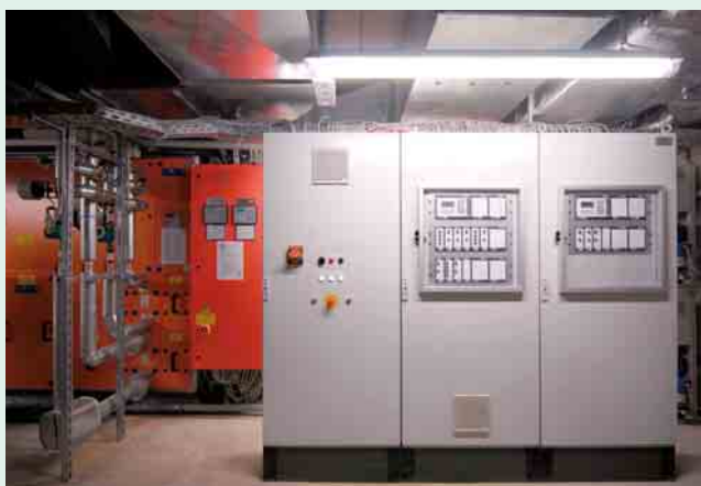
4 Die komplexe Steuerungszentrale wertet alle Signale für die Heizung, Kühlung und Lüftung aus und ist für die klimatische Regelung zuständig. Dabei sorgt sie auch für die automatische Umschaltung der Wärmepumpen in den Sommer- oder Wintermodus
