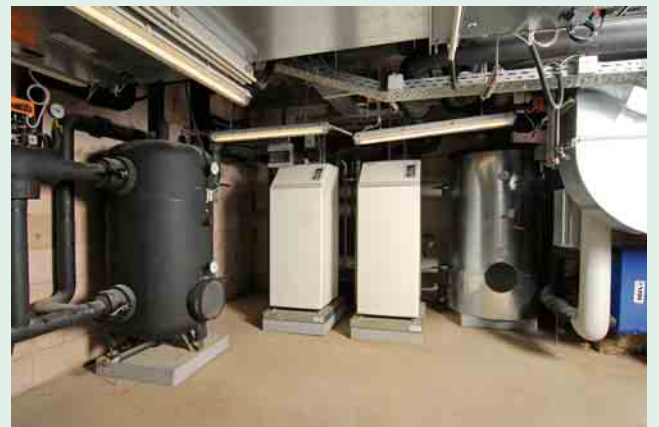
❷ Im Keller des Neubaus befinden sich die zwei Wärmepumpen (Mitte), die den Neubau mit kostengünstiger umweltfreundlicher Umweltenergie heizen und kühlen. Bevorratet wird die Wärme im silberfarbenen Pufferspeicher (rechts) und die Kälte im schwarzen Kühltank (links)
