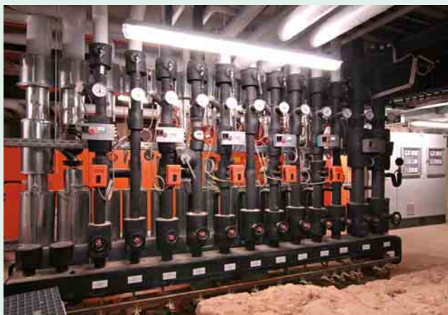
3 Hier werden die Weichen gestellt: Diese Verteileranlage übernimmt die gleichmäßige Verteilung der Wärme und der Kälte im gesamten Gebäude
