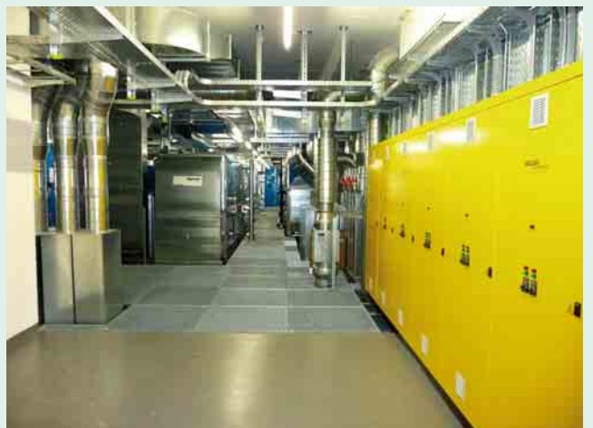
2 Alles an einem Ort: eine der Technikzentralen
