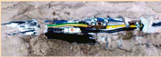
❶ Freigelegte „Reparaturstelle“ – die nicht dicht schließen- de Schrumpfmuffe ist in der Wand freigelegt und teilweise entfernt; in der Muffe wurden die Leiterverbindungen mit unisolierten Leuchten-Anschlussklemmen hergestellt
