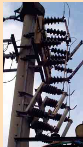
❶ durch einen defekten Stützisolator öffnete sich ein Kontaktmesser nicht
