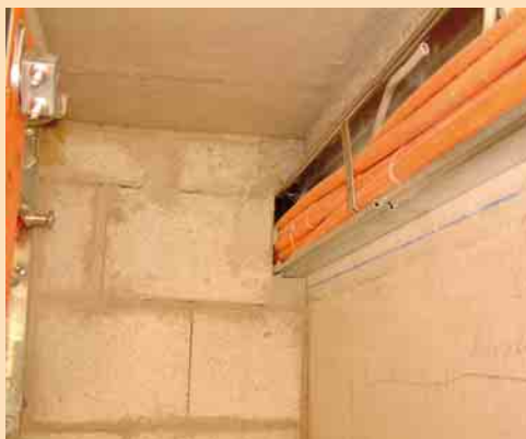
② Kabelführung durch Brandabschnittswände
