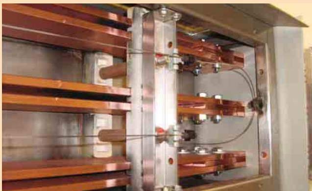
③ gereinigte Sammelschiene nach offener Lichtbogenprüfung mit 10 kA, 300 ms, Lichtbogenlöschung durch Arcon
