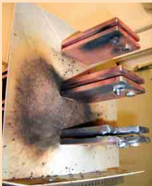
② zerstörte Sammelschiene nach offener Lichtbogenprüfung mit 10 kA, 300 ms, ohne Lichtbogenlöschung
