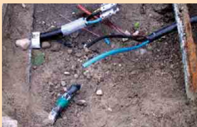
➊ Arbeitsstelle mit Verbindungsmuffe – die Schraubklemmen standen unter Spannung
