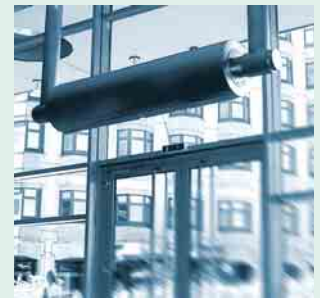
2 Luftschleier in einem Eingangsbereich
