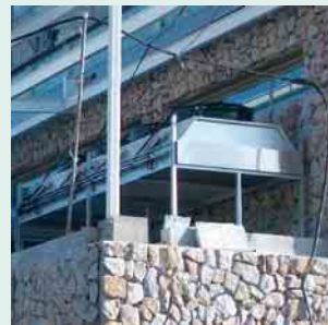
1 Verflüssiger an der Gebäuderückseite eines Supermarktes
