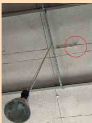
▲ ② Fehler: Kombimelder mit unabhängigem Thermomelderteil in 10 m Höhe
