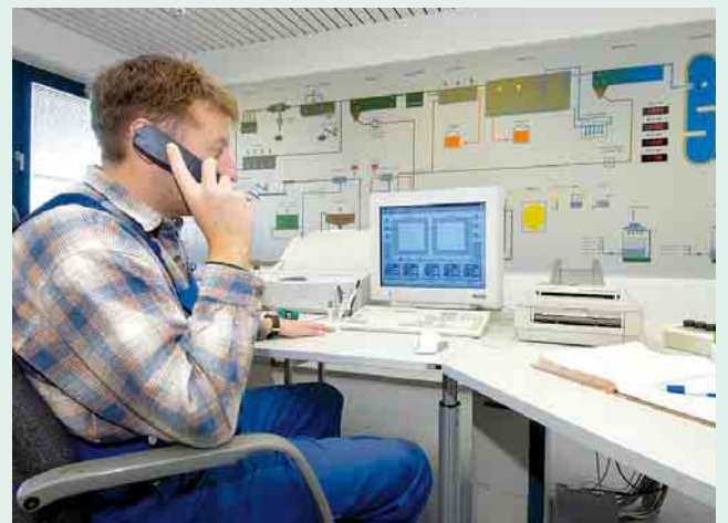
2 Durch das Zusammenführen und Auswerten aller Einzelinformationen aus den angeschlossenen Melde- und Sicherheitssystemen steht in der Leitzentrale ein umfassender Informationspool zur Verfügung
