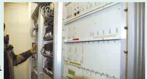
3 130 dezentrale Steuerungen verarbeiten die Daten an 51 Standorten
