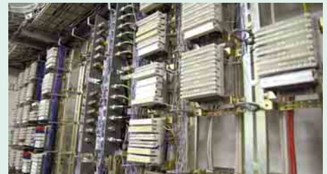
2 Das Leitsystem verwaltet etwa 100 000 Datenpunkte, verteilt über das gesamte Streckennetz
