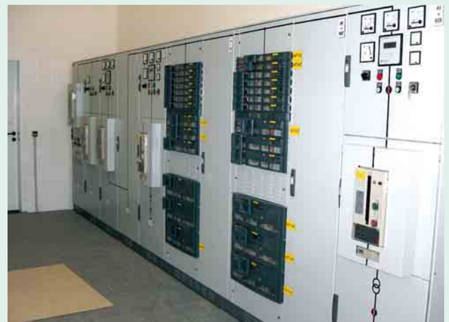
2 Niederspannungshauptverteilung im Dachgeschoss
