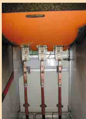
➊ Durch Lichtbogen beschädigte 20-kV-Zelle
