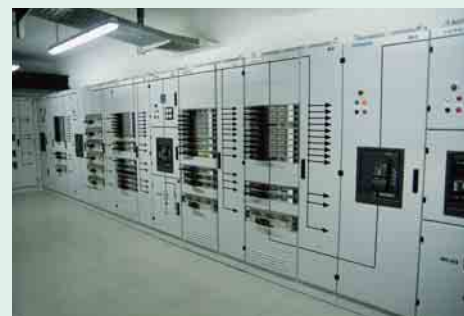
2 Über den reinen Energiesparansatz hinaus wurden weitere Anlagen erneuert, so die NS-Hauptverteilung
