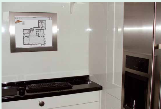
1 Vom zentralen Steuercomputer in der Küche aus lässt sich die gesamte Haustechnik automatisch überwachen und steuern
