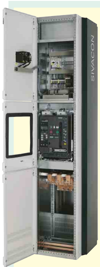
③ Die Funktionsräume der Schaltanlage sind klar voneinander getrennt
