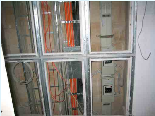
④ Ansicht eines Steigepunktes Elektro
